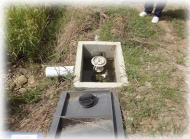
パイプラインの台座及び地下灌漑
