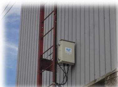
倉庫に設置した通信ボックス
