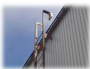
倉庫に設置した無線ボックス
