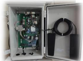
事務所内の通信ボックス
