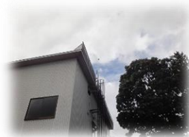
事務所の屋根に設置した無線ボックス
