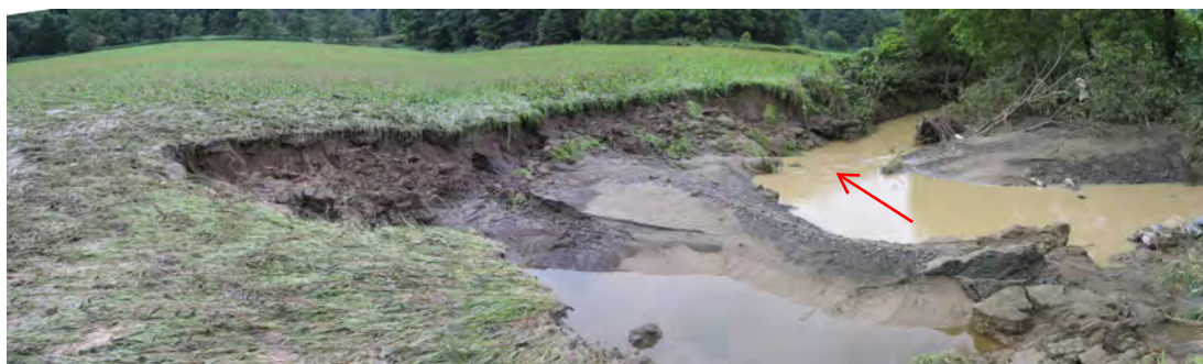
平成 22 年 8 月の二十三号川 きつこう 桔杭橋下流の浸水被害（河岸欠壊による農地被害）
