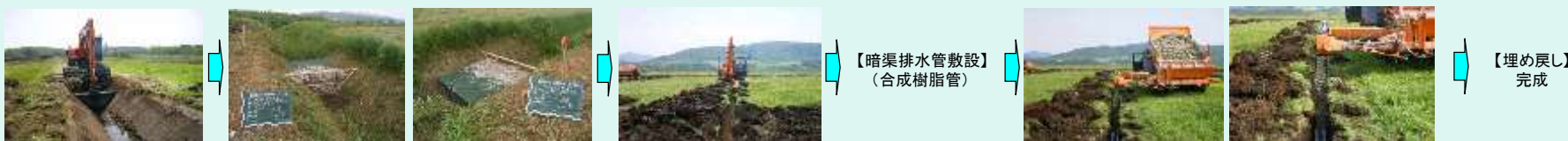
【附帯明渠掘削】 ※必要に応じて施工 【汚濁水処理施設設置】 ※写真は施工例です。形式等は変更となる可能性があります。 【暗渠掘削状況】 【暗渠排水管敷設】 (合成樹脂管) 【フィルター材投入】 【埋め戻し】 完成
