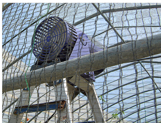
写真 循環送風機の設置例
